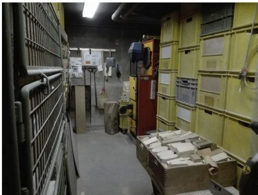
Heizungskelle, rechts der Ofen
